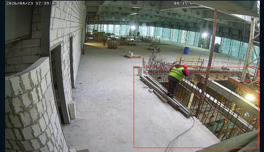
Нарушение периметра опасной зоны
