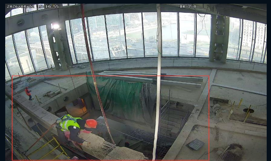
Нарушение периметра опасной зоны
